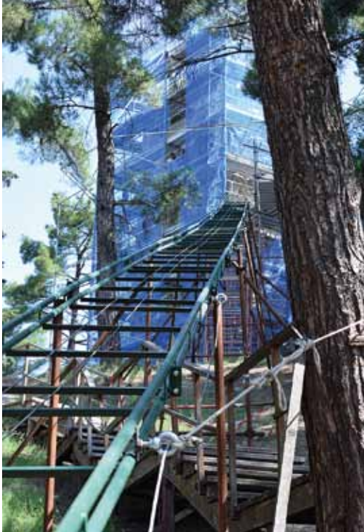
Εικ. 53. Αναβατήριο για την μεταφορά των υλικών στην ακρόπολη των Σερβίων. Fig. 53. Lift for the transport of materials to the citadel of Servia.
